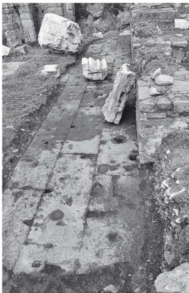
4. La fondazione in blocchi di tufo del muro occidentale della cella (M. Vitti).
