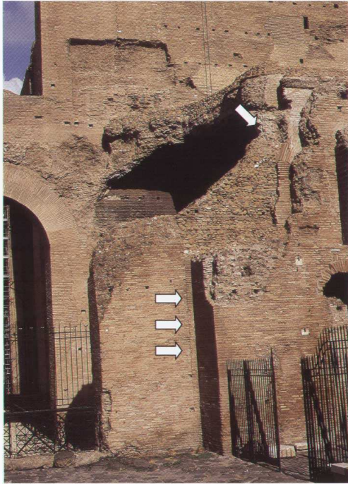
FIG. 2.45. Muro perimetrale Est. Malgrado gli interventi successivi, è ancora leggibile la tamponatura della finestra di cui resta anche parte della ghiera in bipedali, contro cui è stato costruito il piedritto orientale dell'arco di contrasto. Visibile anche la sezione di una delle crociere di copertura del portico, con estradossato terrazzato in tre strati di cocciopesto.
