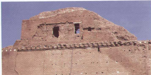
FIG. 2.32. Contrafforte nord orientale, parete esterna. Chiaramente visibile il varco di accesso e l'imposta della volta del balcone aggettante, malgrado le profonde tracce lasciate dai successivi interventi conservativi; a sinistra, lo stipite di una delle finestre della facciata Est.
