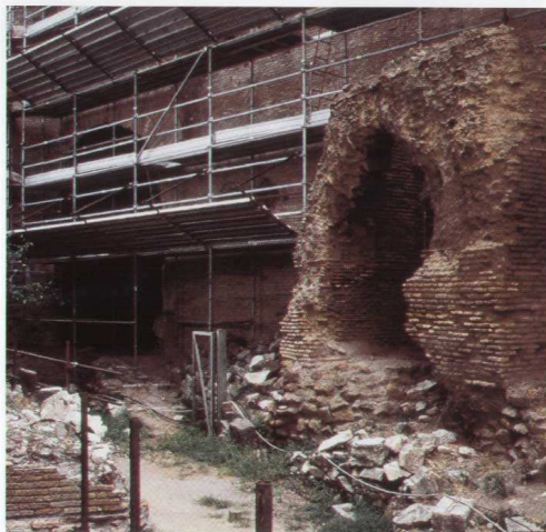
FIG. 2.42. Via «ad Carinas», arco di contrasto in opera laterizia, con ghiera e piani di imposta in bipedali, tra il muro perimetrale del Templum Pacis e il lato Ovest della Basilica. Rimangono scarsi resti del piedritto occidentale, ma una parte sufficiente di quello opposto per identificare almeno due elementi voltati sovrapposti. In quello inferiore è stata ricavata una fontana, foderando piano di calpestio e pareti interne in cocciopesto. Il livello del piano di spiccatto conferma la seriazione cronologica proposta (cfr. Fig. 2.12).
