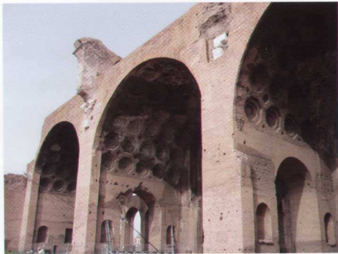
FIG. 2.23. Lato Nord, sistemi voltati delle campate laterali. L'articolazione per archi passanti dei setti murari sottostanti l'imposta delle volte a botte provvede a concentrare le risultanti sulle estremità perimetrali, consentendo inoltre uno sfruttamento ottimale dello spazio interno, ed una adeguata partizione per una efficace decorazione architettonica. Sull'apporto dei setti ortogonali sono impostati anche i contrafforti esterni delle crociere di copertura della navata centrale, di cui uno in parte visibile, con un segmento di imposta, fornendo ulteriore contributo alla stabilità del sistema. I tiranti trasversali, messi in opera nel 2003, fanno parte di un consolidamento provvisorio e provvisorio del settore Nord-Ovest, per riportarlo in condizioni di sicurezza in attesa del completamento delle indagini strutturali finalizzate all'elaborazione di sistemi di consolidamento definitivo.
