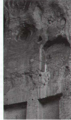
FIG. 2.47. Abside Nord, particolare del lato Est. Il pilastro di testata della schermatura a colonnato libero della nuova abside è stato addossato al segmento murario originale finestrato, tagliato e risarcito, che opportunamente media l'aggancio, architettonicamente non perfettamente calibrato, tra la nuova struttura e la volta a botte della corrispondente navata laterale.
