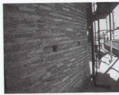
FIG. 5.10. Abside Nord, esterno. Aggiustamento di cantiere garantito da un ricorso di bipedali.
