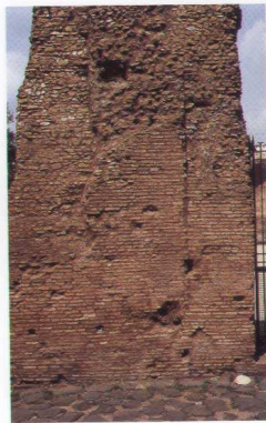
FIG. 5.35. Portico, lato Sud. Finestra trasformata in porta in corso d'opera, occupando parte del davanzale con l'ampliamento del muro di stipite per ridurne l'ampiezza.
