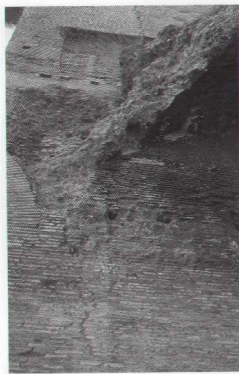
FIG. 5.26. Impronta e resti di tubo di cantiere, ancora ben conservati. Per la costruzione della serie di crociere di copertura del portico, di limitato impegno statico, non si è ritenuto opportuno ricorrere a nervature.
