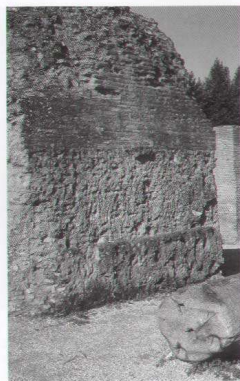
FIG. 5.33. Pilastro della navata laterale Est. Sovradimensionato nel lato Nord di cm 60 per una altezza di m 2, è stato scalpellato fino ad ottenerne il corretto dimensionamento. È ancora in posto parte della malta di allettamento della decorazione applicata in lastre di marmo.
