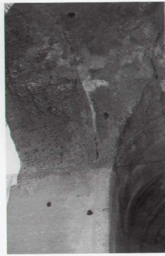
navata laterale. La larghezza dell'arco è inferiore a quella dei piloni di sostegno per consentire un più solido appoggio all'imposta della crociera; tutta la superficie intradosale era poi rivestita di lastre rettangolari di marmo. Come riscontrabile altrove, i due sistemi, sottoposti a sollecitazioni molto diverse, non sono ammassati. I tubi di cantiere, ancora in posto, evidenziano il limite esterno del muro superiore.
