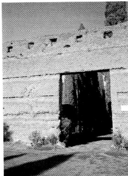
Fig. 1 Villa Adriana: apertura praticata nel muro di spina del cosiddetto Pecile senza alcuna protezione alla sommità; sulla spalla sinistra è visibile la sgranatura di un colpo di artiglieria. (foto dell'A. prec. i recenti restauri)
