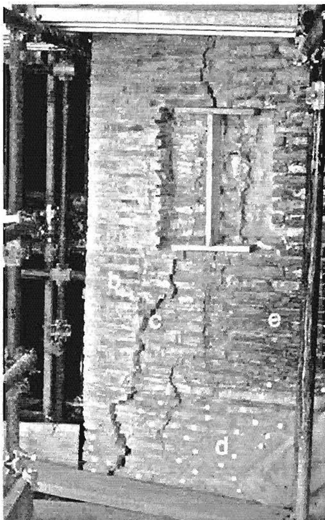
Fig. 6 - Domus Tiberiana. Facciata nord-est. Arco II.3. pilone esterno: b, e: paramento "alla gotica" del restauro di Rosa. Il paramento non è attraversato da lesioni, d: paramento antico bollinato; f: sinistra aperta nella muratura per verificare la profondità delle lesioni (c), che concernono solo il paramento del restauro del 1900.
