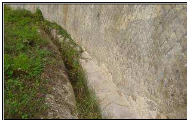
13. Canaletta per la raccolta delle acque meteoriche
